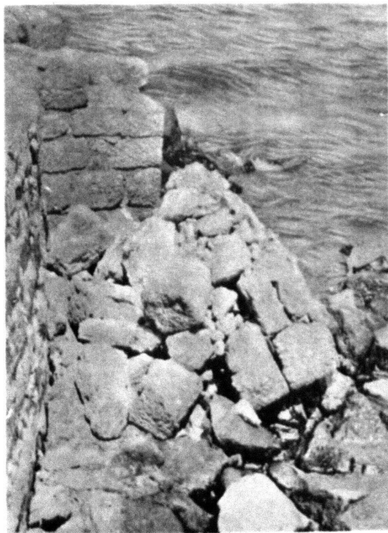
№ 4. Петровскъ. Видъ полуразрушенной части охранной стѣнки на Южномъ молѣ.
