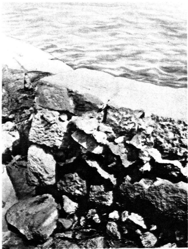
№ 20. Поти. Видъ разрушенныхъ массивовъ на волноломѣ съ внѣшней стороны.
